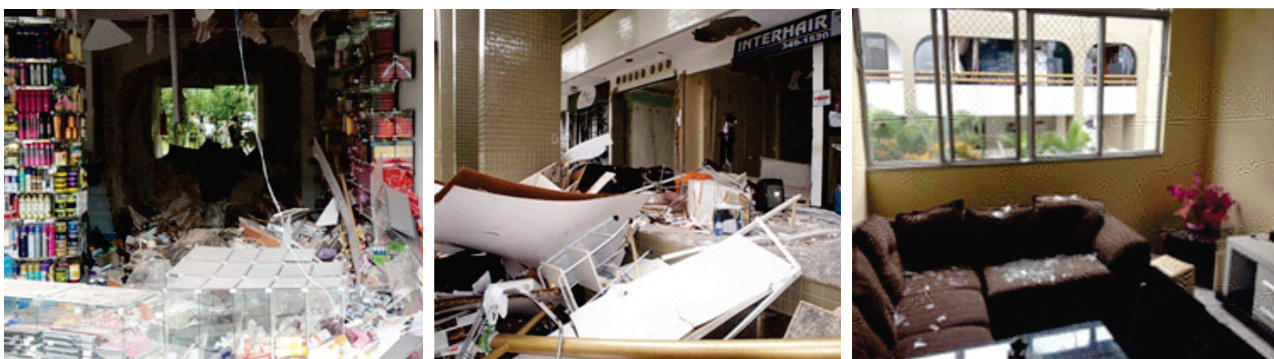
Figura 4.7 – Patologia causada pela explosão de restaurante em Brasília: As figuras mostram a destruição das alvenarias de vedação que separavam o restaurante de uma farmácia, os danos causados nas lojas vizinhas e nas casas de moradoras de apartamento da quadra. (G1, 2013).
