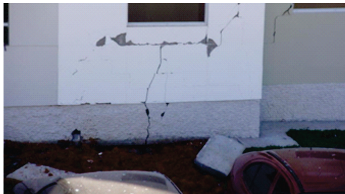
Figura 4.6 – Patologia causada pela explosão de bolsão de GLP abaixo do prédio da Caixa Econômica do projeto Minha Casa, Minha Vida (Diário Catarinense, 2012).
