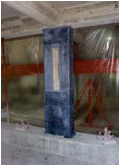
Figura 5.4 – Aplicação de epóxi e utilização de compósitos de fibras de carbono para reforços (Varum. et al, 2005).
