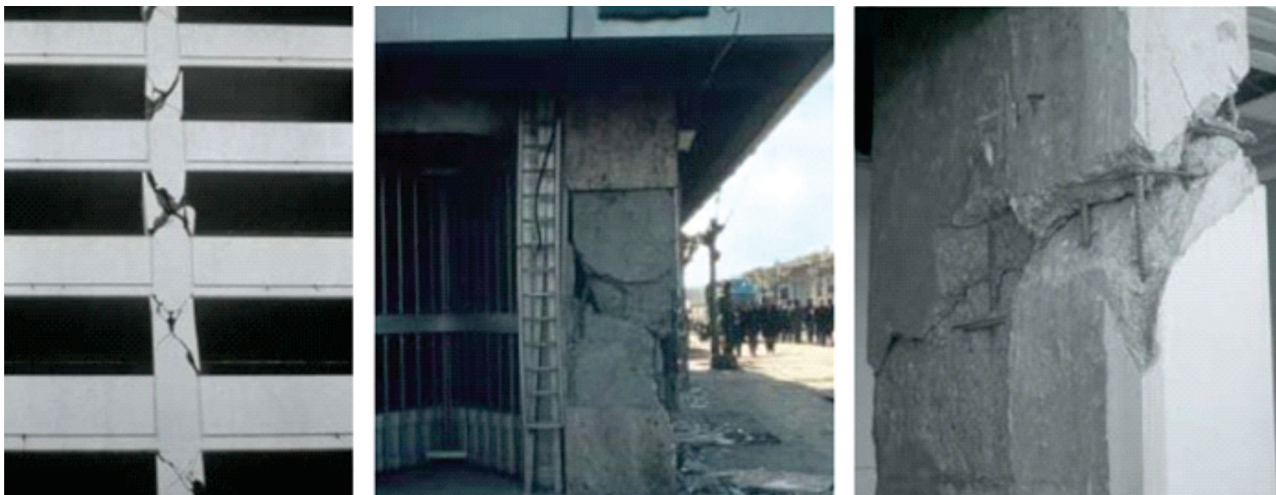
Figura 4.1 – Exemplo de patologia gerada em colunas curtas (Dantas, 2013).
