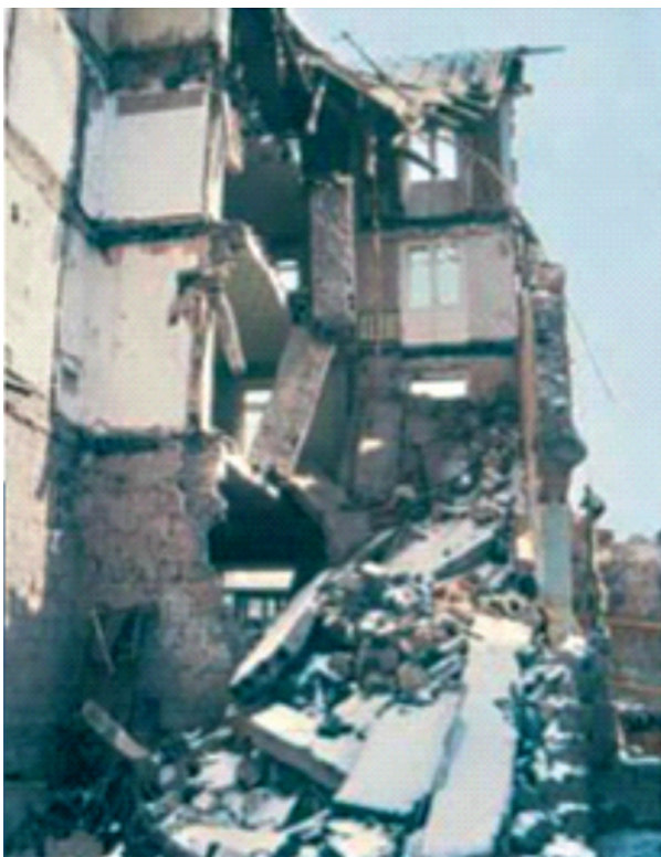
Figura 4.2 – Falha no comportamento de diafragma das lajes (Dantas, 2013).
