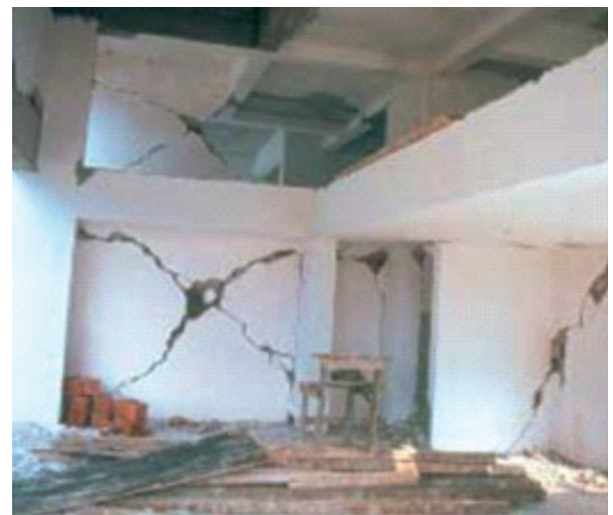
Figura 4.4 – Patologia gerada pelas solicitações horizontais; fissura em diagonal simples e em cruz (Dantas, 2013).
