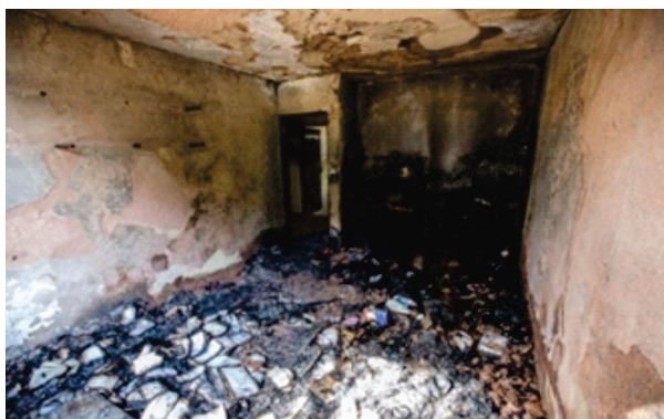
Figura 4.10 – Deslocamento do revestimento e calcinação das paredes e laje; paredes rosa (300° C), teto amarelo alaranjado (950° C).
